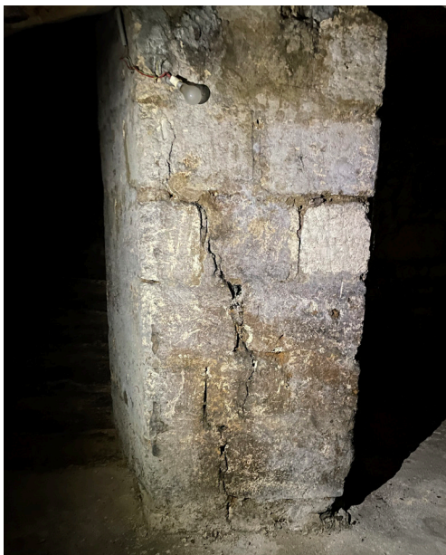
Fissure sur la pile en pierre en cave
